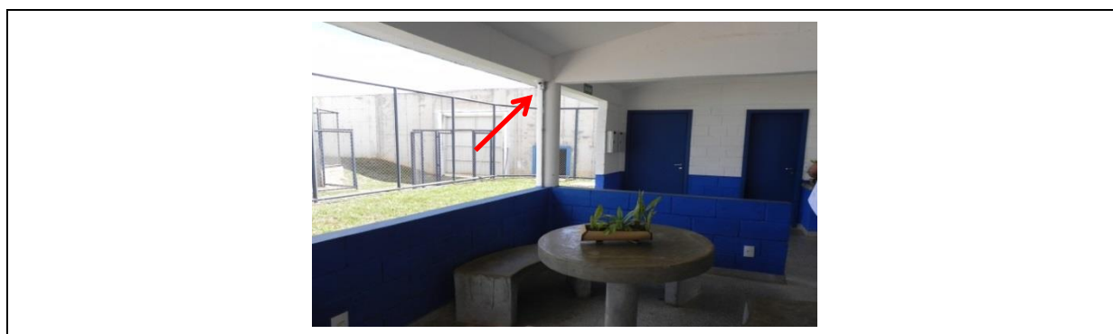
FIGURA 7 – UNIDADE DE INTERNAÇÃO DE SANTA MARIA – INSTALAÇÃO DE CÂMERAS EM LOCAIS INADEQUADOS
