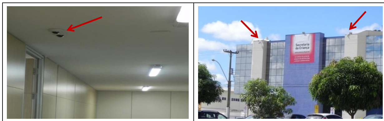
FIGURA 6 – SEDE DA SECRIANÇA – CÂMERAS INSTALADAS EM LOCAIS NÃO PREVISTOS.
