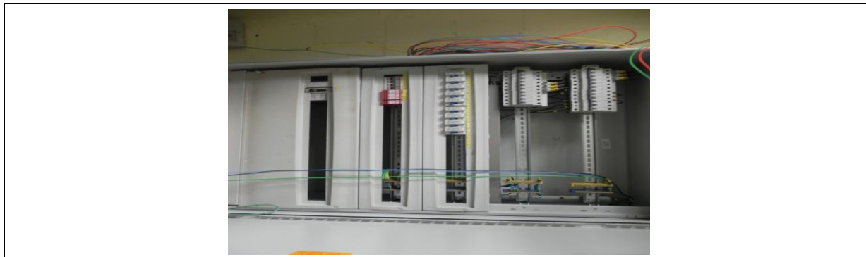
FIGURA 8 – UNIDADE DE INTERNAÇÃO DE BRAZLÂNDIA – QUADRO DE DISTRIBUIÇÃO DE ENERGIA INATIVO
