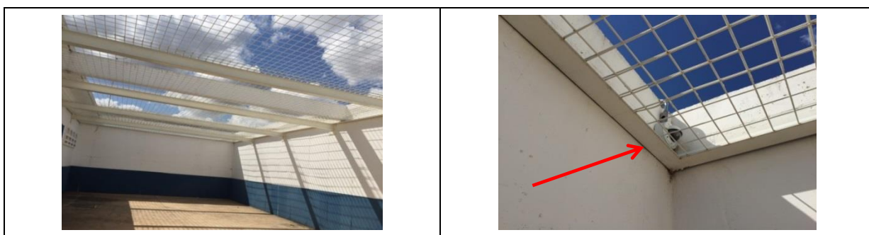
FIGURA 2 –UNIDADE DE INTERNAÇÃO DE SÃO SEBASTIÃO – CÂMERA INSTALADA EM LOCAL INADEQUADO
